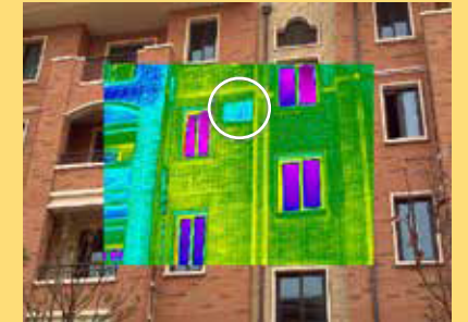
外牆維修後未填實，該處容易滲水
